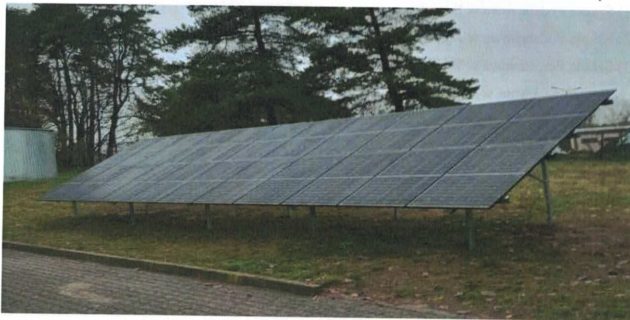
Rys. 1. Mikroinstalacja fotowoltaiczna na ujęciu wody w Wielkim Leźnie wykonana w 2025 r.
